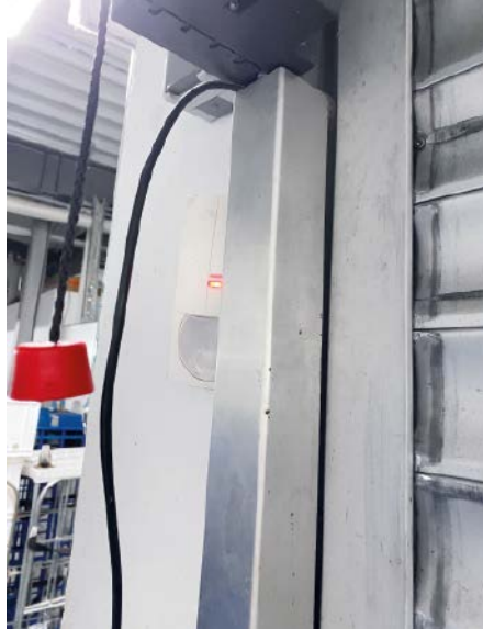
Oftmals wird es dem Täter aber auch sehr leicht gemacht, einen Bewegungsmelder zu umgehen. Bei diesem Melder wird ein Großteil des Überwachungsbereiches durch die seitliche Führungsschiene des Rollltores verdeckt
