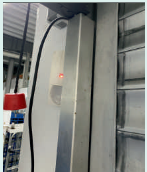
Abbildung 3: Der Bewegungsmelder ist durch die Führungsschiene eines Rolltors stark im Überwachungsbereich eingeschränkt (Foto: Sascha Puppel)
