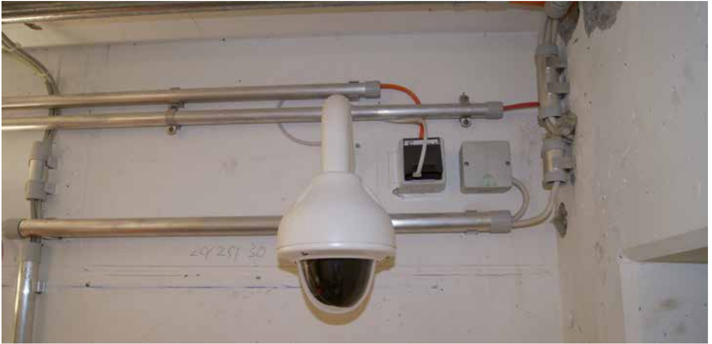
Bild 2: Steckernetzteil einer Kamera in Schuko-Steckdose im ungeschützten Außenbereich.
