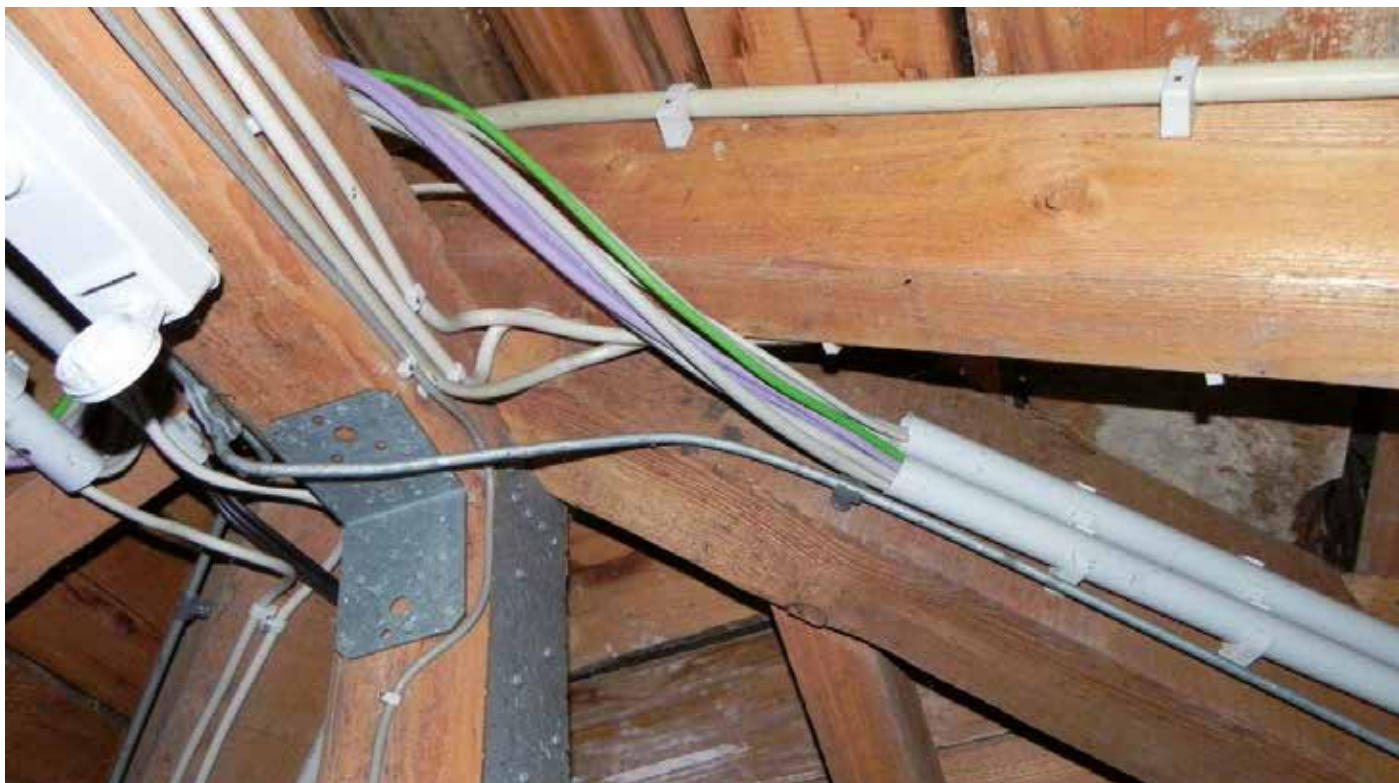
Bild 3: Nicht eingehaltener Trennungsabstand von Leitungen zu Blitzableiter.
