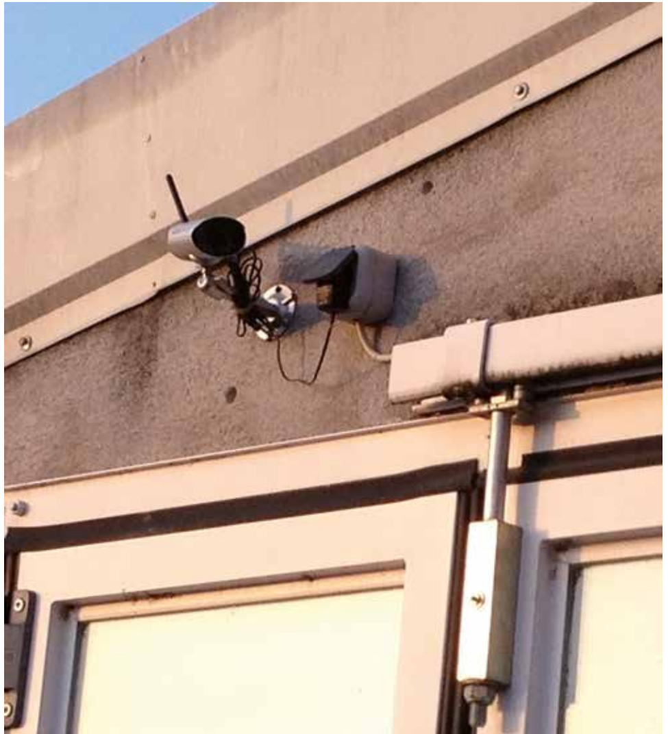
Bild 1: Steckernetzteil einer Kamera in Schuko-Steckdose im ungeschützten Außenbereich.
